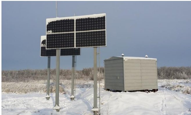
КП ТМ с ВИЭ для многониточного газопровода
