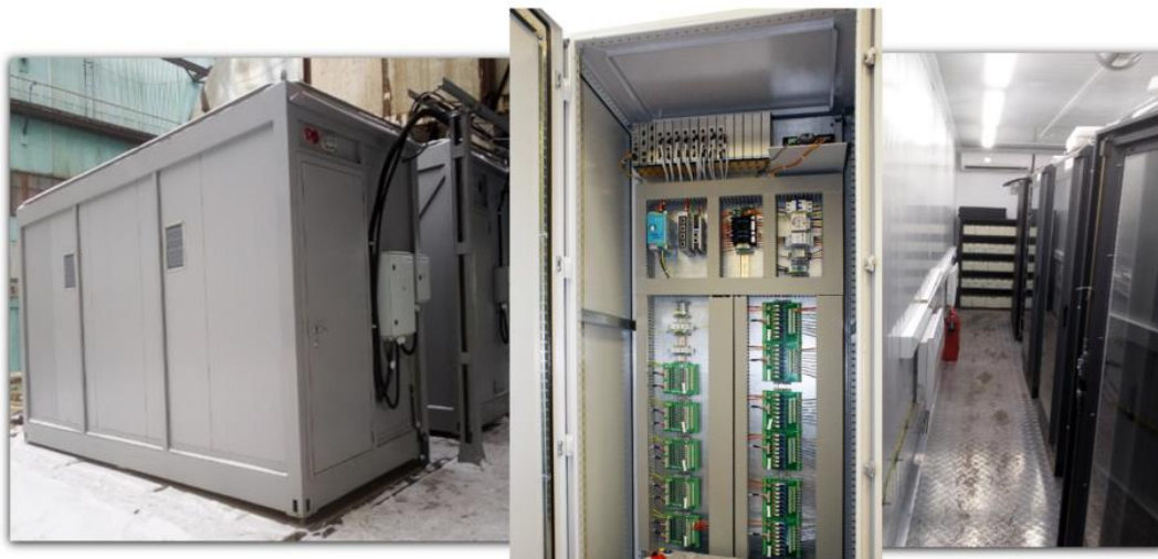
Рис. 4. Пример реализации среднего уровня АСКВ. В центре – шкаф СТН-3000-Р.
